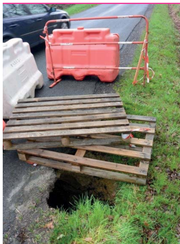
L'effondrement se trouve le long de la RD 38.
